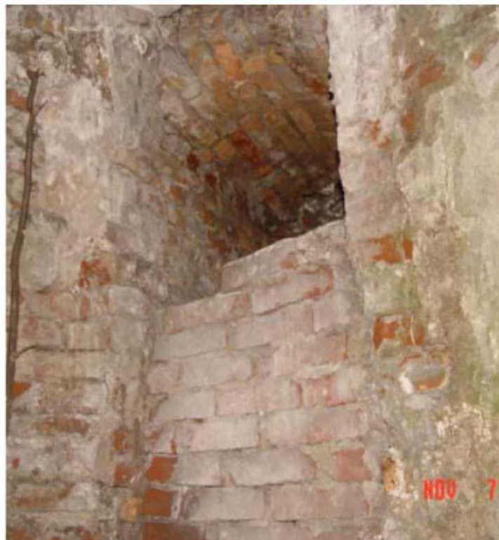
Una delle strutture murarie nel sottosuolo di Lodi, dove esiste un'altra città
